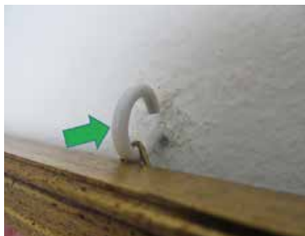
Fig. 3 - Quadro “sicuro”, fissato con un gancio chiuso.
